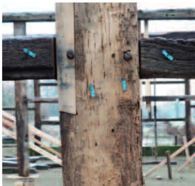
Marken an allen Knotenpunkten helfen das Puzzle zu lösen. Gut zu erkennen: die Ausbesserung einer schadhaften Stelle.
